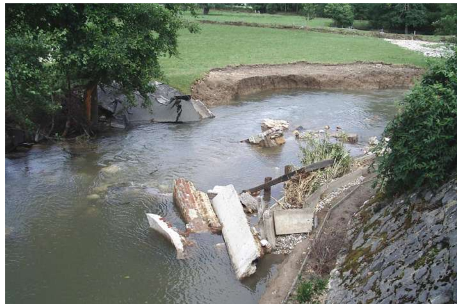
Effondrement à Clerques : le 12 Août 2006 est tombé 187 mm de pluie en 22 h (à noter qu'une pluie importante "habituelle" à cette même époque est de 50 à 60 mm.)
