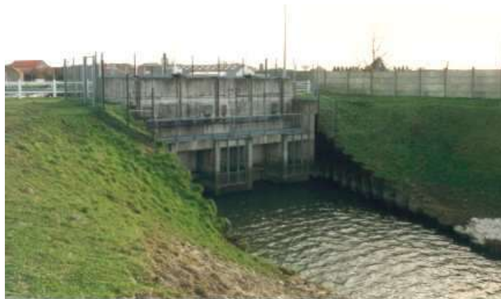
Ouvrage hydraulique sur la rivière d'Oye faisant obstacle à la libre circulation piscicole (GRAVELINES)
