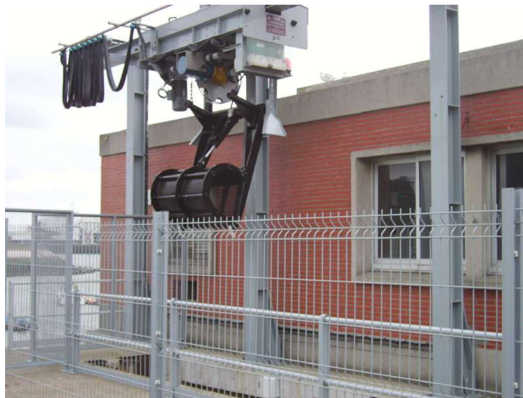
Dégrilleur de la station de pompage de CALAIS dont la capacité totale est de 4m 3 /s
