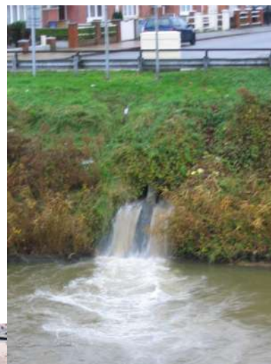
Déversoir d'orage en débordement en milieu urbain
